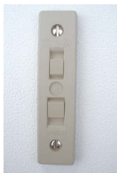
1053 (洗面所コンセント)
