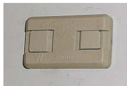
1377 (洗面所コンセント)
